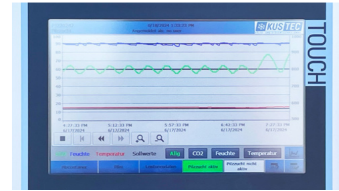
Contrôle de la climatisation intérieure
