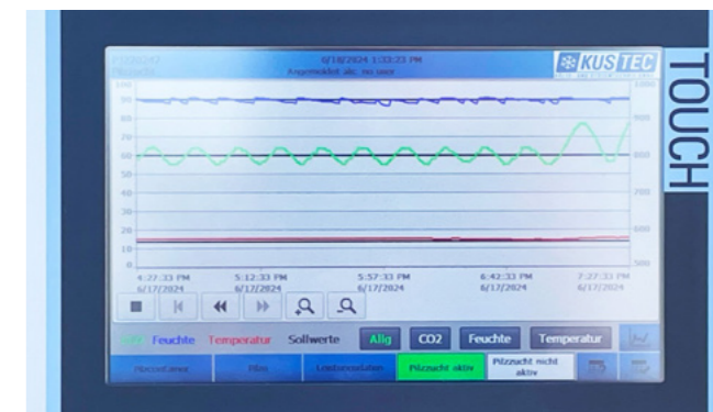
Control de la climatización interior
