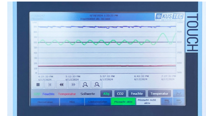
Steuerung des Innenraum-Klimas
