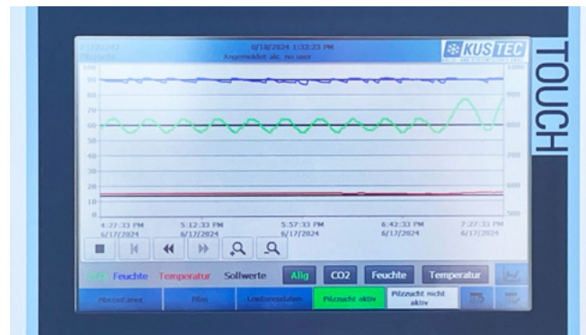
Steuerung des Innenraum-Klimas
